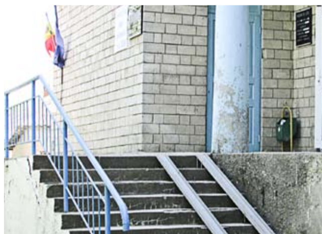
Rampa de acces de la intrarea în secția de votare din Ruseștii Noi. Foto: Lilia Zaharia
