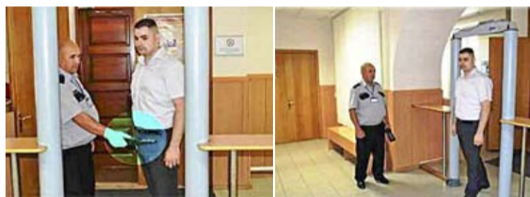
Sistemul de detectare a metalelor instalat la intrarea în CA Cahul. Sursa: CA Cahul
