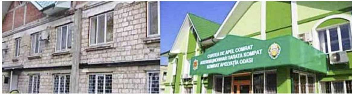
Exteriorul Curții de Apel din Comrat până și după renovare. Sursa: CA Comrat
